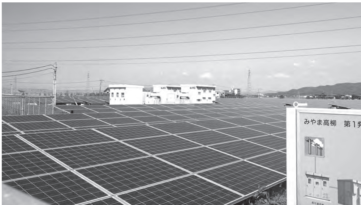
みやま高柳発電所
